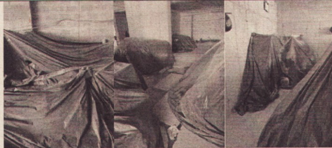
Ilustración 16. Instalación de las mallas protectoras en los frentes y costados de la construcción.
