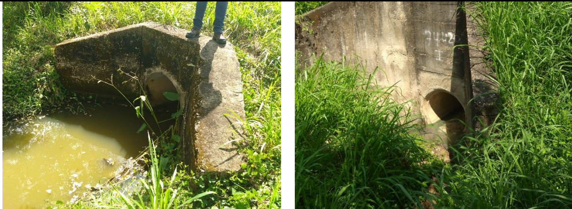
Imagen 5. Estructuras en donde se evidenció agua estancada
